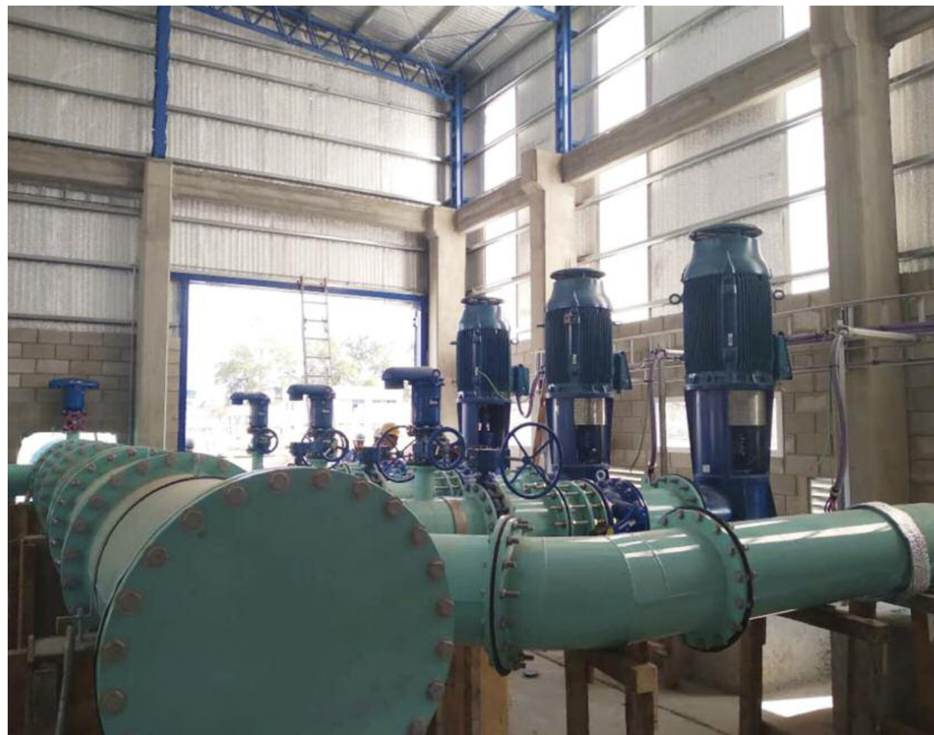
Estación de bombeo de agua potable - Reconquista. Fuente: ASSA
